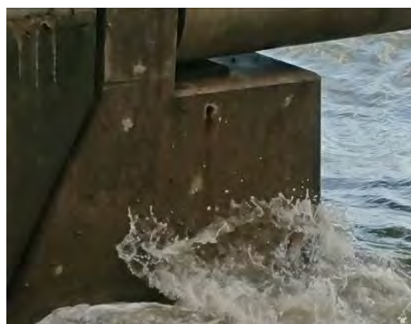
写真-2 セパ穴からの錆
